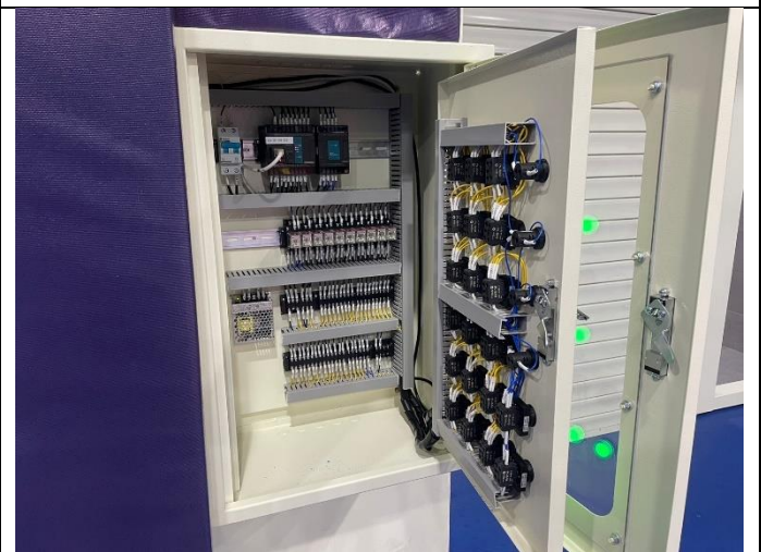
誠信館 1樓設備控制盤內
