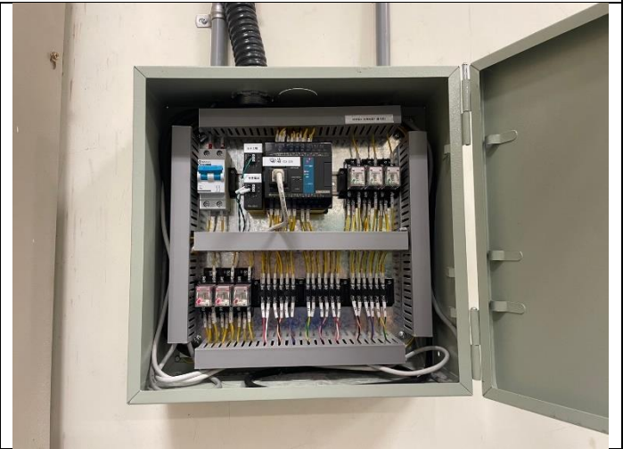
冰水主機控制盤內
