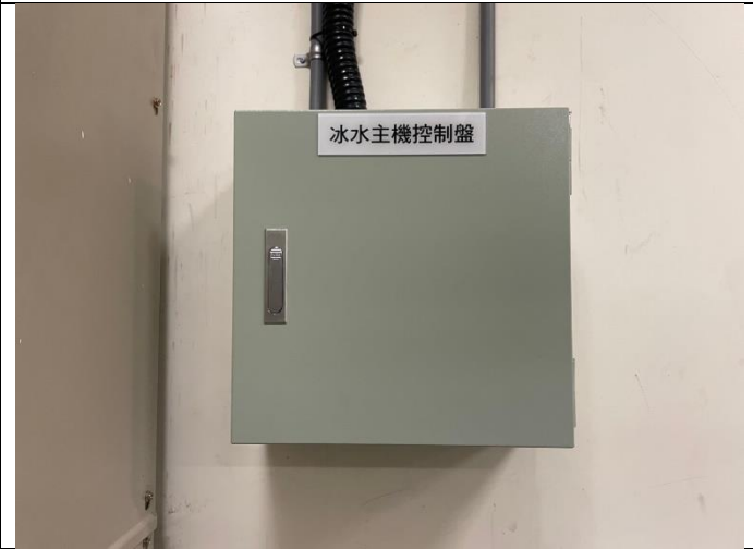
冰水主機控制盤
