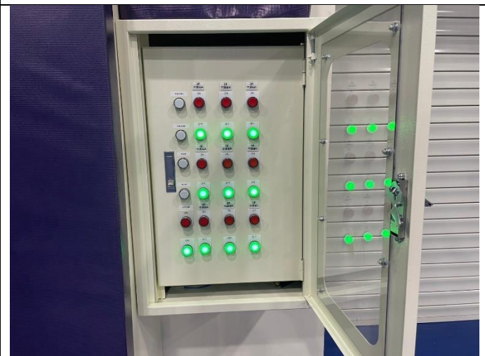
誠信館 1樓設備控制盤
